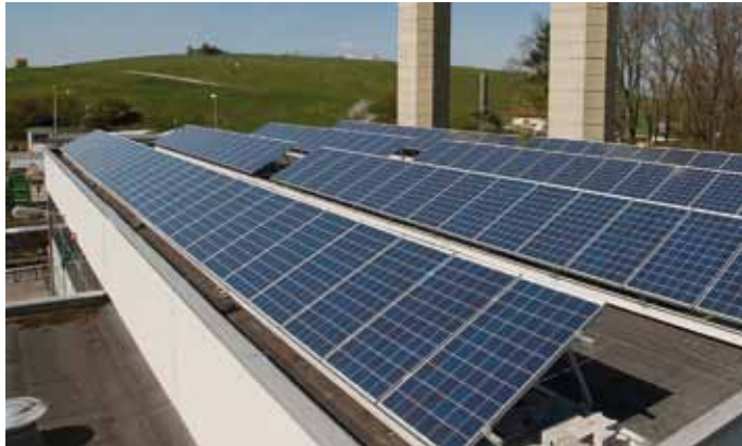
Photovoltaikanlage auf dem Heizkraftwerk
