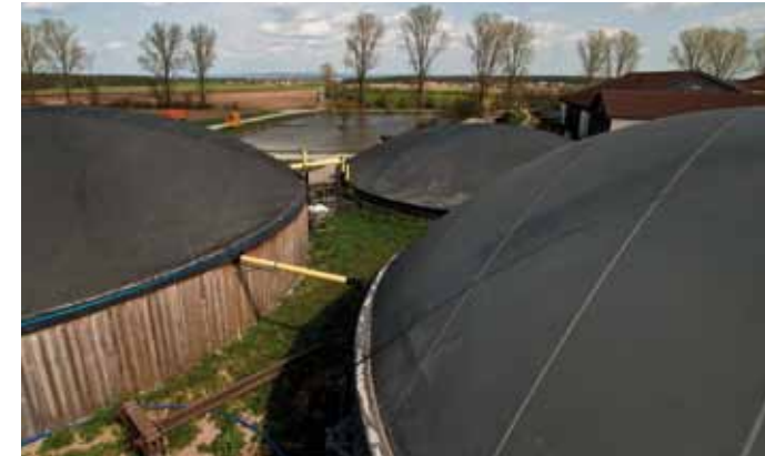
Biogasanlage in Zweifelsheim
