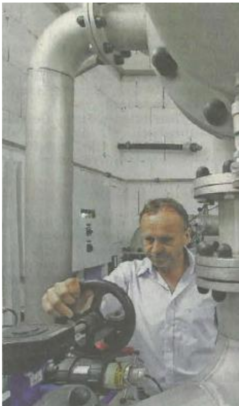
Hier läuft das Wasser aus den Brunnen zusammen. Alfons Schocke! in der UV-Desinfektionsanlage. Fotos: Bösl
